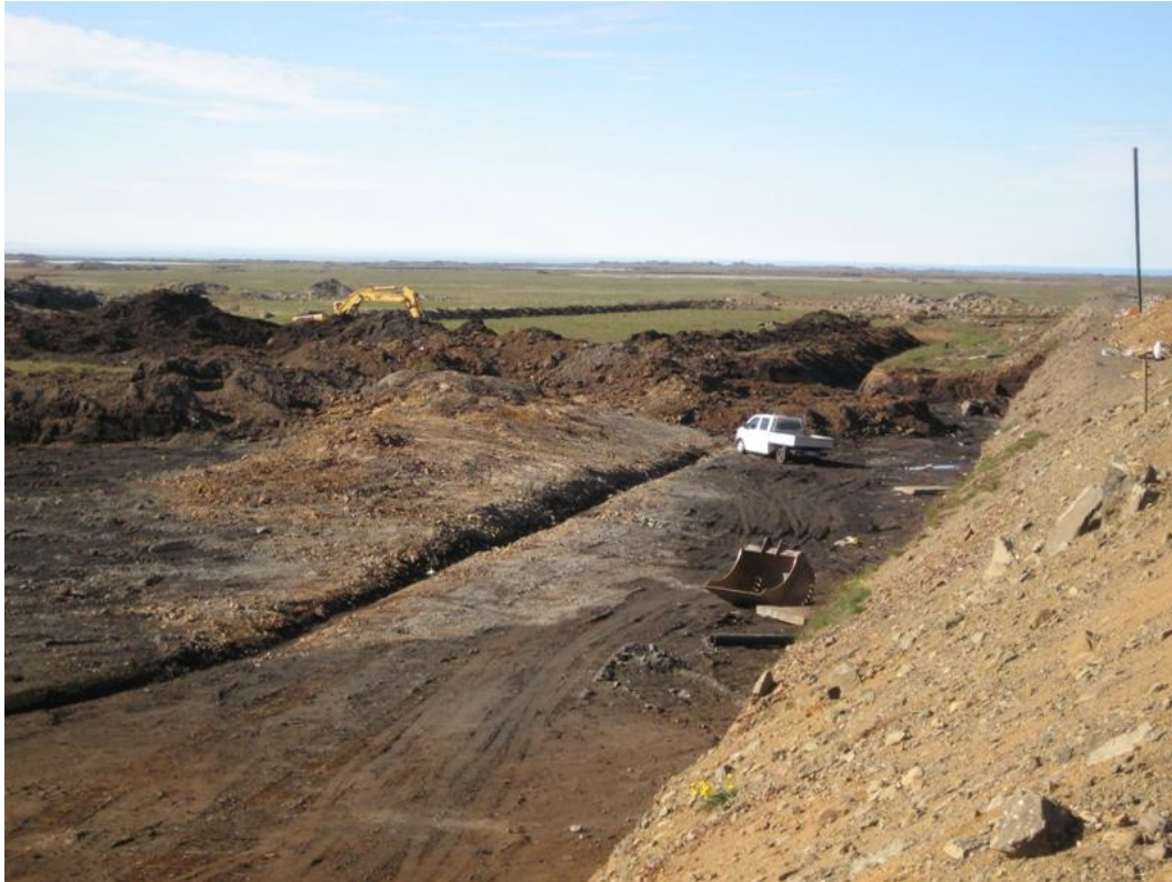
Mynd 6.1. Framkvæmdir hafnar við urðunarrein nr. 4 í Fíflholtum sumarið 2008. Myndin er tekin til suðurs. (Ljós. Stefán Gíslason).
